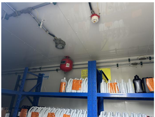
危废仓库现场照片
