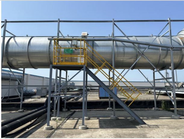
1#排气筒取样口、取样平台
