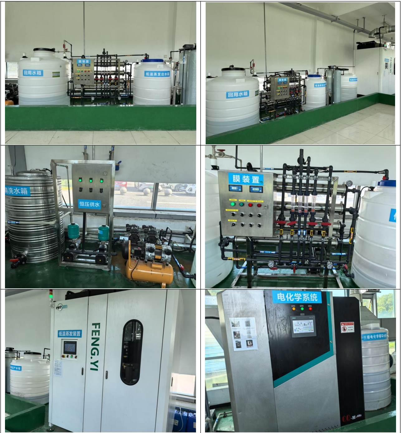
废水处理设施
