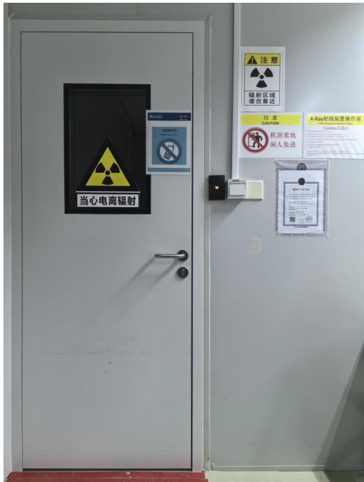
项目拟建址南侧（X-ray 射线装置操作室 2）
